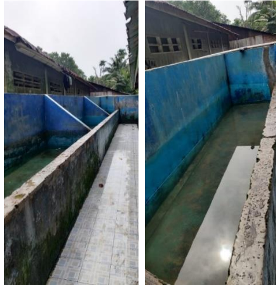
Gambar 2. Kondisi Bak Air pada Kamar Mandi Santri Laki-laki
