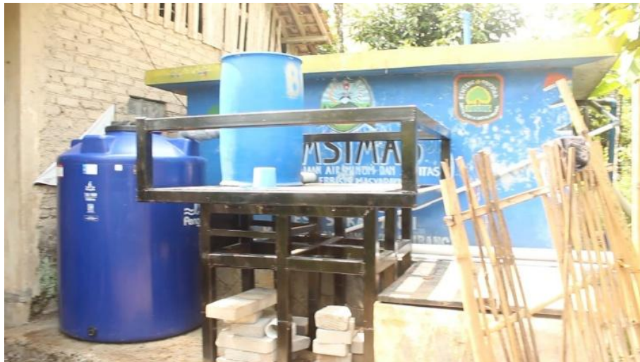
Gambar 3. Kondisi setelah sistem filtrasi terpasang
