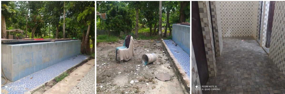
Gambar 2. Kondisi prasarana pada Pesantren Hidayatullah
