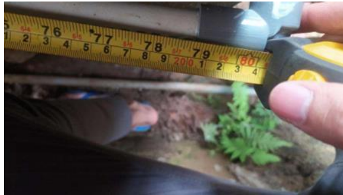
Gambar 5. Pengukuran yang akurat pada sistem perpipaan
